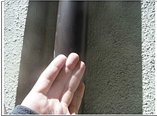
縦樋チョーキング無し
