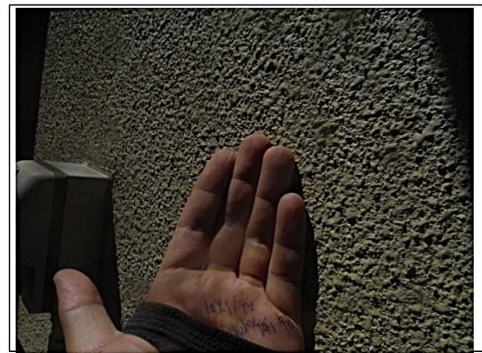
外壁チョーキング多少確認
