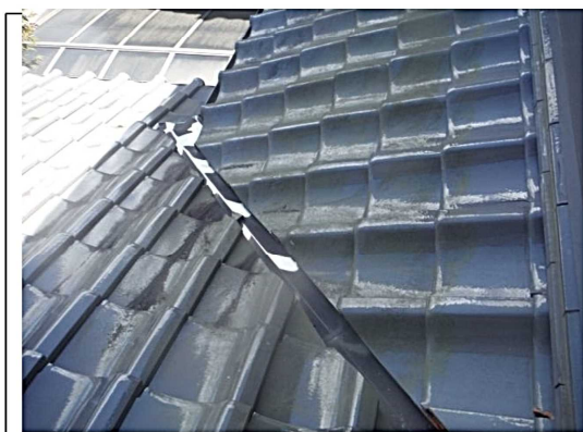
下屋根 釉薬和瓦 劣化傾向
