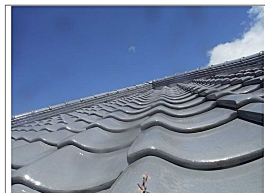
大屋根 釉薬和瓦 劣化傾向
